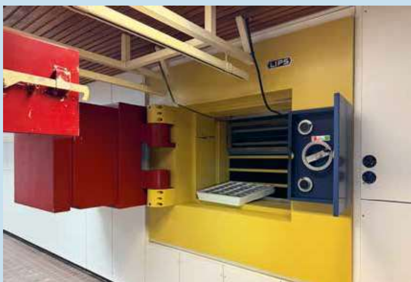
Ventilatiekanaal naar de kluis dat met een dik, stalen luik kan worden dichtgezet.
