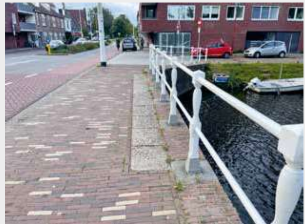
De witte tegels op het trottoir van de Wolfsbrug kunnen eruit worden gehaald om toegang te krijgen tot de onderliggende sponningen en de schotbalkken hierin te kunnen hijsen.
