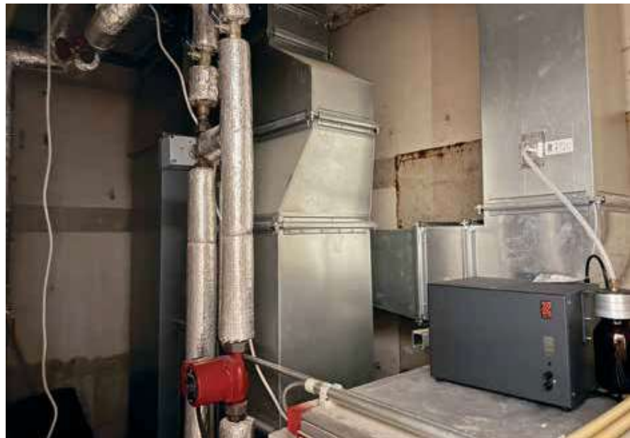
Voormalige luchtbehandelingsruimte van de BB-commandopost waarin nu hedendaagse installaties staan.
