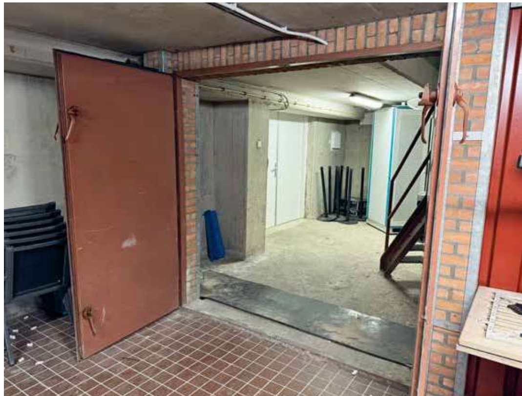
Gasdichte stalen deuren in de openbare schuilplaats De Vest naar de ruimte waar de koolstoffiltertonnen voor de luchtverversing stonden.
