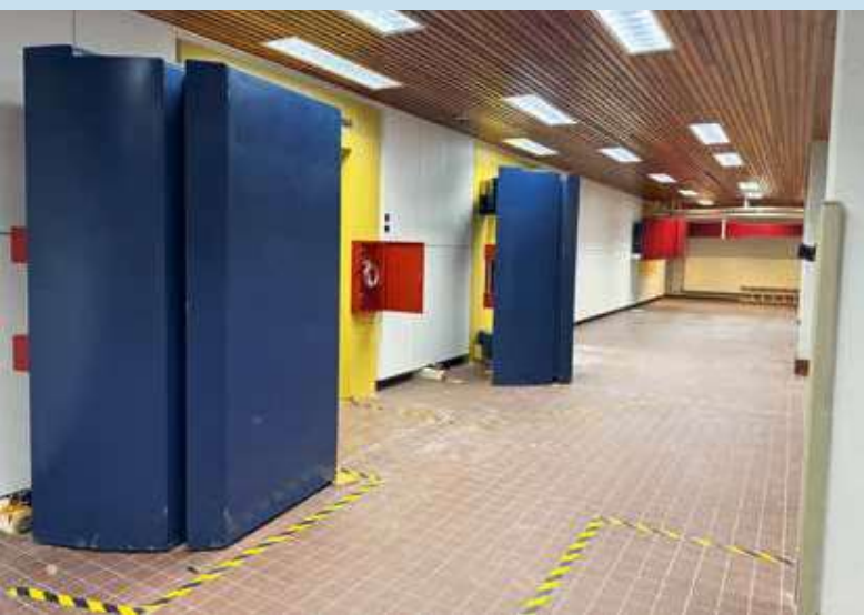
Het voorportaal van de kluis met de twee kluisdeuren op de voorgrond en op de achtergrond het rode ventilatiekanaal naar de kluis.
