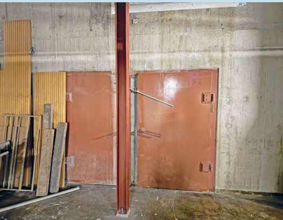
Gasdichte stalen deuren naar de inblaasgang. Tegenwoordig is de doorgang achter deze deuren dichtgemetseld.
