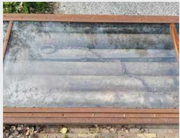
Bak met schotbalkken bij de Wolfsbrug, met een nieuwe, doorzichtige deksel zodat de schotbalkken zichtbaar zijn.
