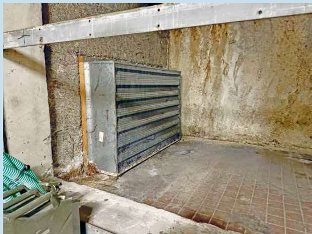
Restanten van de luchtinstallatie in de mengkamer, het rooster van het recirculatiekanaal.
