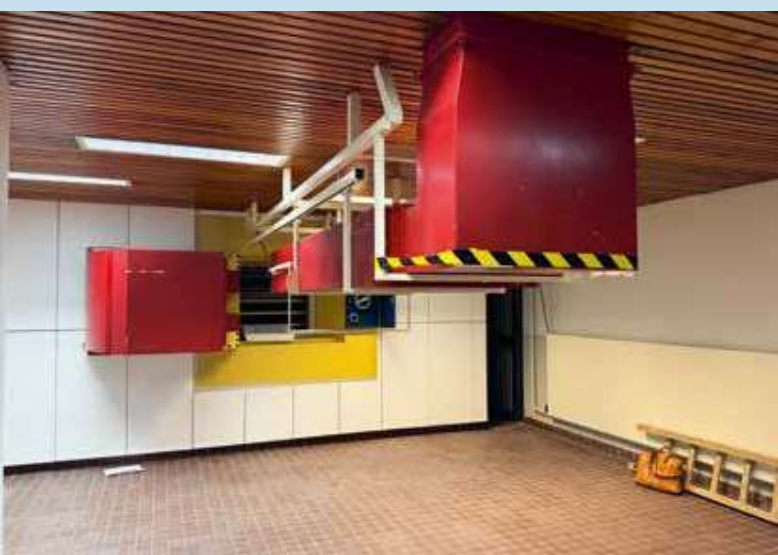
Het flexibele ventilatiekanaal kan in de opening van de kluis worden geschoven wanneer het stalen technisch luik openstaat.
