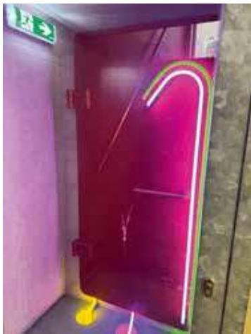
Nog aanwezige stalen, gasdichte deur in een trappenhuis van de parkeergarage. Deze is door een kunstenaar creatief verlicht.
